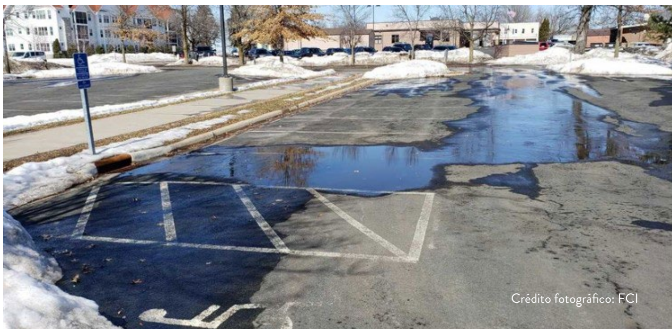
Figura 17: Diseño deficiente: espacio de estacionamiento accesible con un desagüe pluvial.
