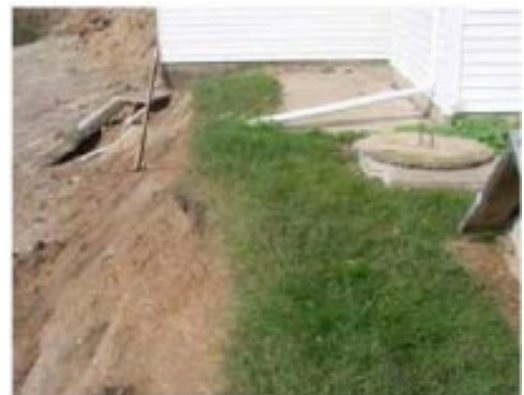
SSTS arrastrado en un banco de arroyo erosionado
