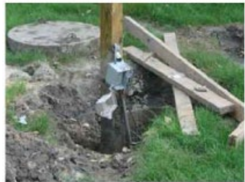
caja eléctrica de SSTS dañada por la inundación
